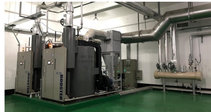
부산 물류센터 내 저녹스 등유 보일러
